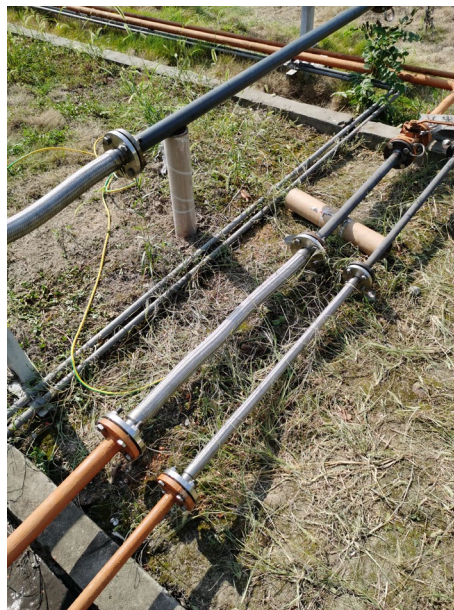
溶剂储罐进出管道柔性连接
