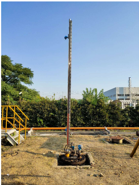
溶剂储罐增加磁翻板液位计
