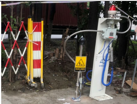
卸油口防静电接地装置
