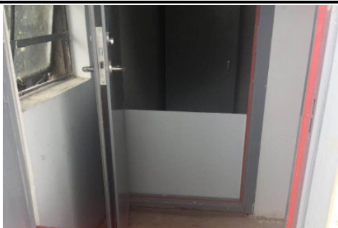
配电间防小动物挡板
