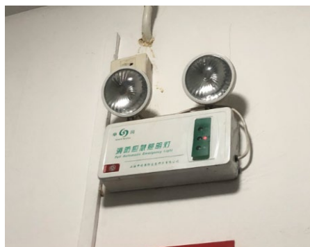
配电间应急灯
