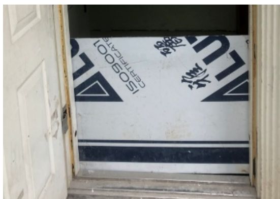
配电间防小动物挡板
