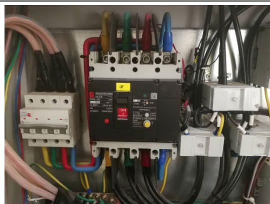
配电间总电源开关
