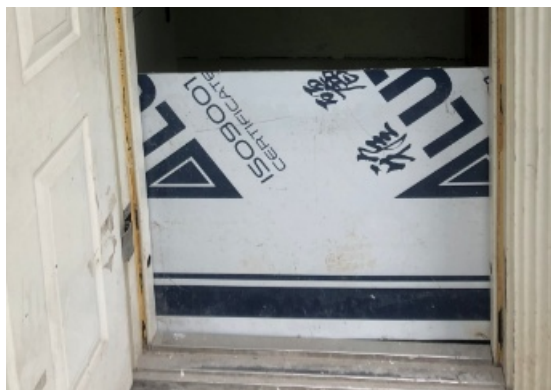
配电间防小动物挡板
