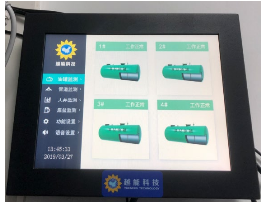
双层油罐、双层管道在线监测显示屏
