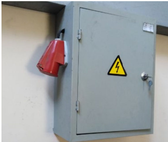
配电箱警示标识
