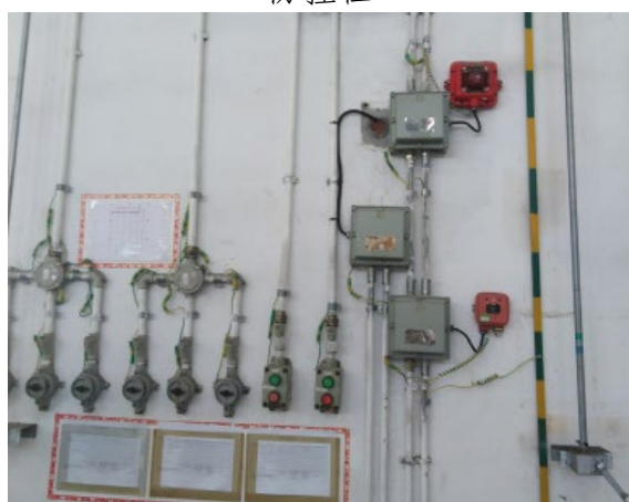
防爆开关设置在建筑外
