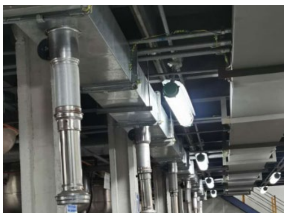
车间应急照明装置
