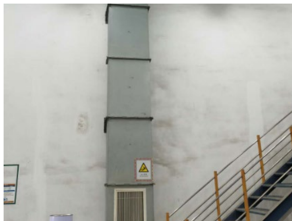
车间通风管道
