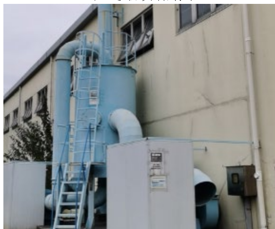
车间除尘装置
